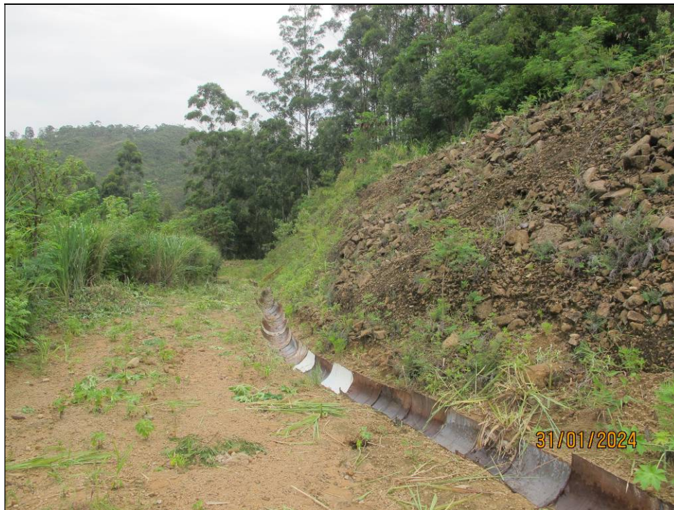
Figura 9.1- Vista da estrada de acesso à crista do barramento e do sistema de drenagem superficial principal.
