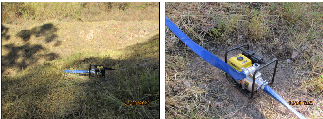
Figura 6.2- Detalhe do conjunto de bombeamento.
