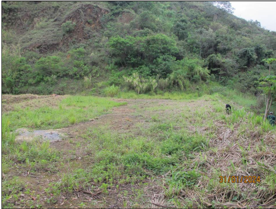
Figura 9.5- Vista da crista do barramento e da ombreira esquerda do dique D-03.
