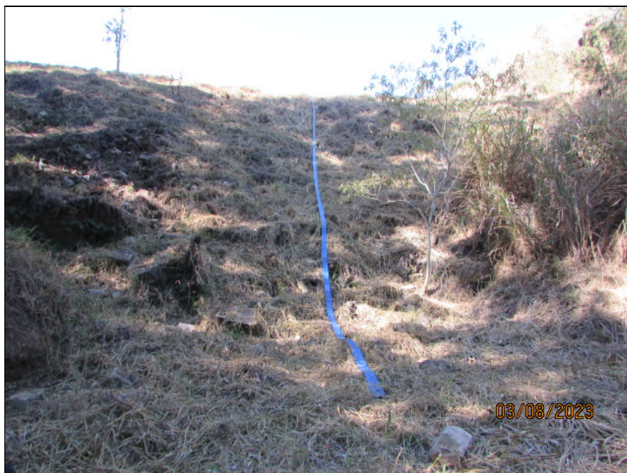
Figura 6.4- Posicionamento do mangote no ponto de lançamento após o pé do talude na região de jusante.
