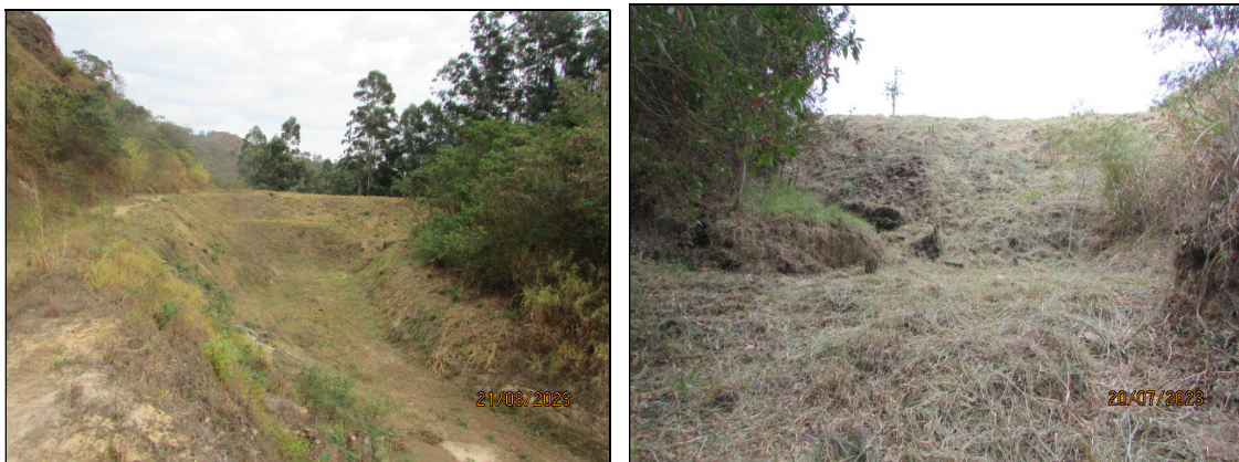
Figura 3.4- Vista dos taludes de montante e de jusante após a operação rotineira de capina da face dos taludes.
