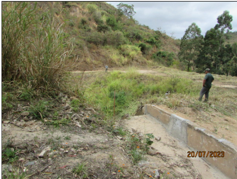
Figura 4.3- Vista do ponto de emboque do sistema de drenagem da estrada de acesso na escada de transferência de fluxo para o interior do reservatório.
