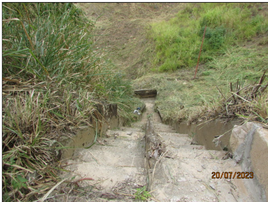
Figura 4.4- Vista da escada de transferência de fluxo para o interior do reservatório, a partir do ponto de desembocadura do sistema de drenagem superficial.
