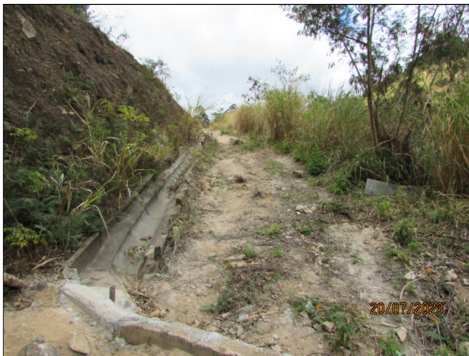
Figura 4.2- Vista do sistema de drenagem superficial na estrada de acesso principal a crista do barramento.
