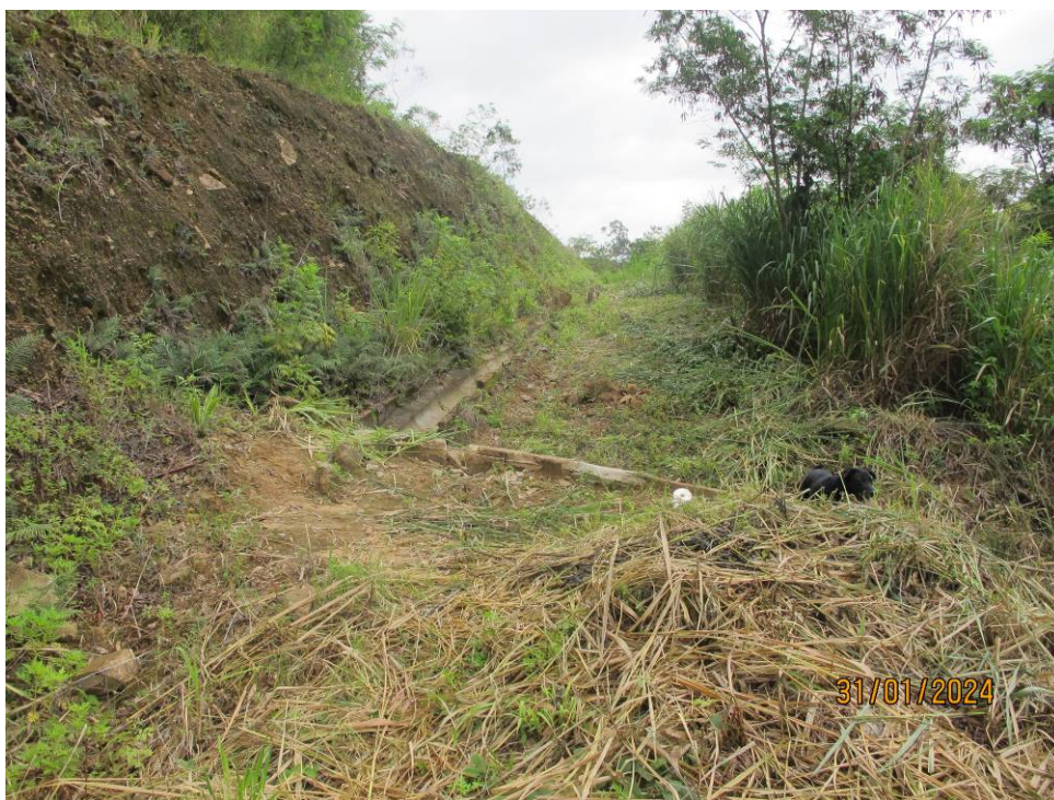
Figura 4.2- Vista do ponto de transferência do sistema de drenagem superficial para o emboque da escada de transferência de fluxo para o interior do reservatório.
