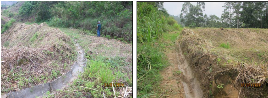
Figura 4.9- Canaleta de drenagem localizada na crista do talude de montante para a condução do fluxo até a escada localizada próxima à ombreira esquerda.
