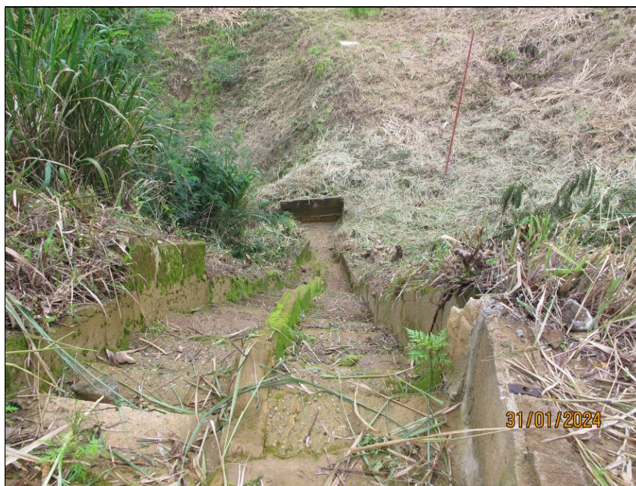
Figura 4.3- Vista da escada de transferência de fluxo para o interior do reservatório, a partir do ponto de desemboque do sistema de drenagem superficial.
