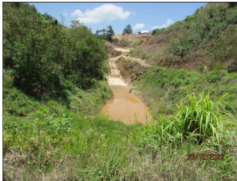
8- Registro de 26/10/2022– Pequeno acúmulo de água no interior do reservatório.
