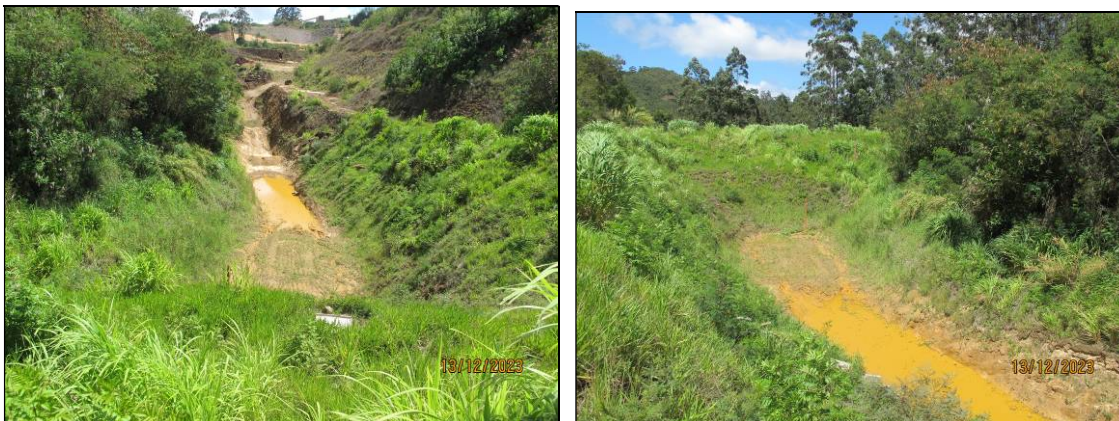
Figura 17- Registro de 13/12/23 – Pequeno acumulo de água no reservatório.
