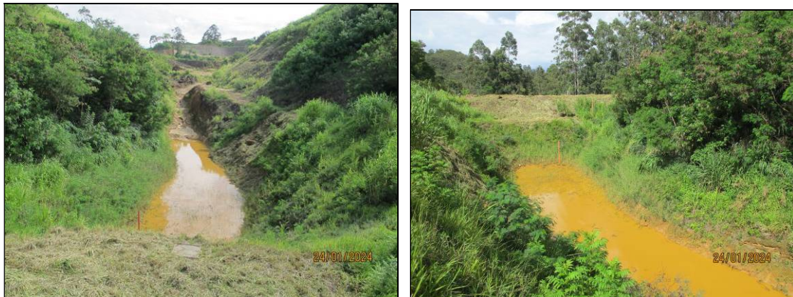
Figura 23- Registro de 24/01/24 – Pequena lâmina de água acumulada no fundo do reservatório.
