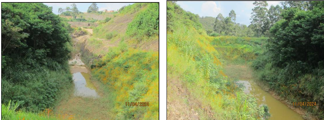
Figura 32- Registro de 11/04/24 – Redução do volume de água acumulada no reservatório – Lâmina d’água não alcança a face do talude de montante – h = 0 cm.
