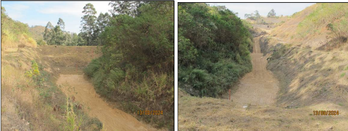
43- Registro de 13/08/24 – Reservatório completamente “seco”.
