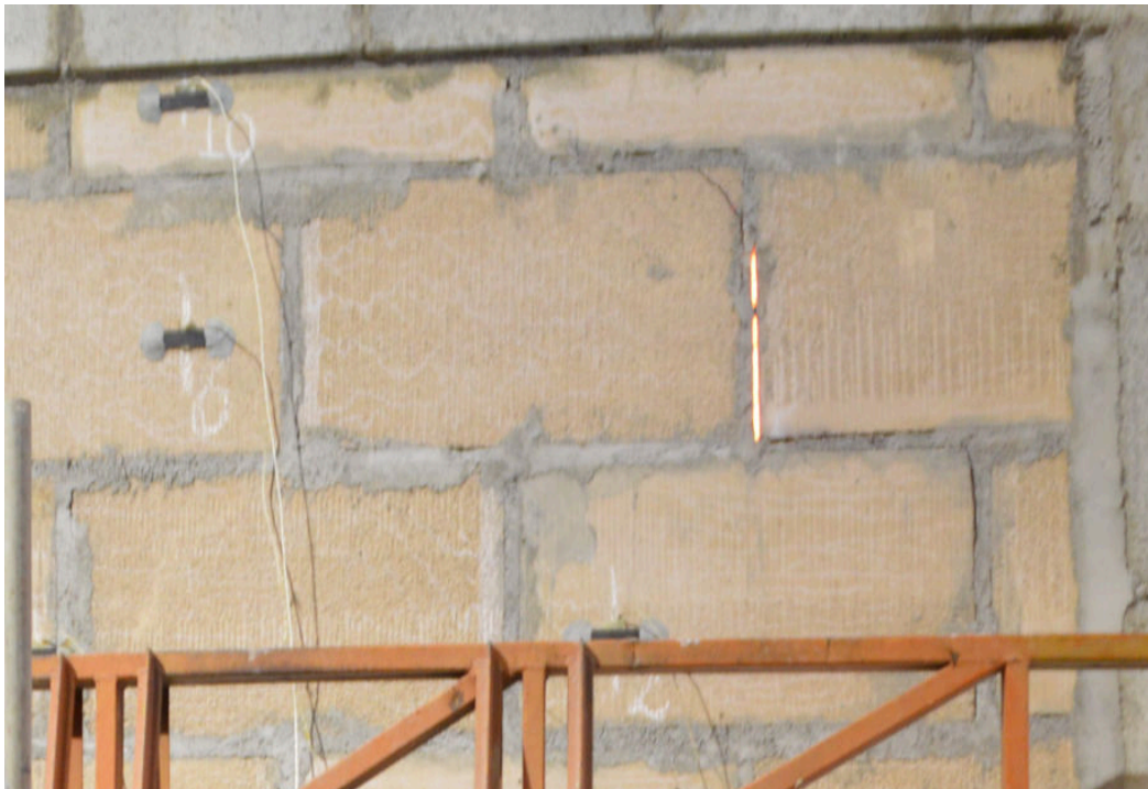
Fotografia 8 – Surgimento de uma fresta entre bloco e junta, devida a retração recorrente da exposição ao fogo.
