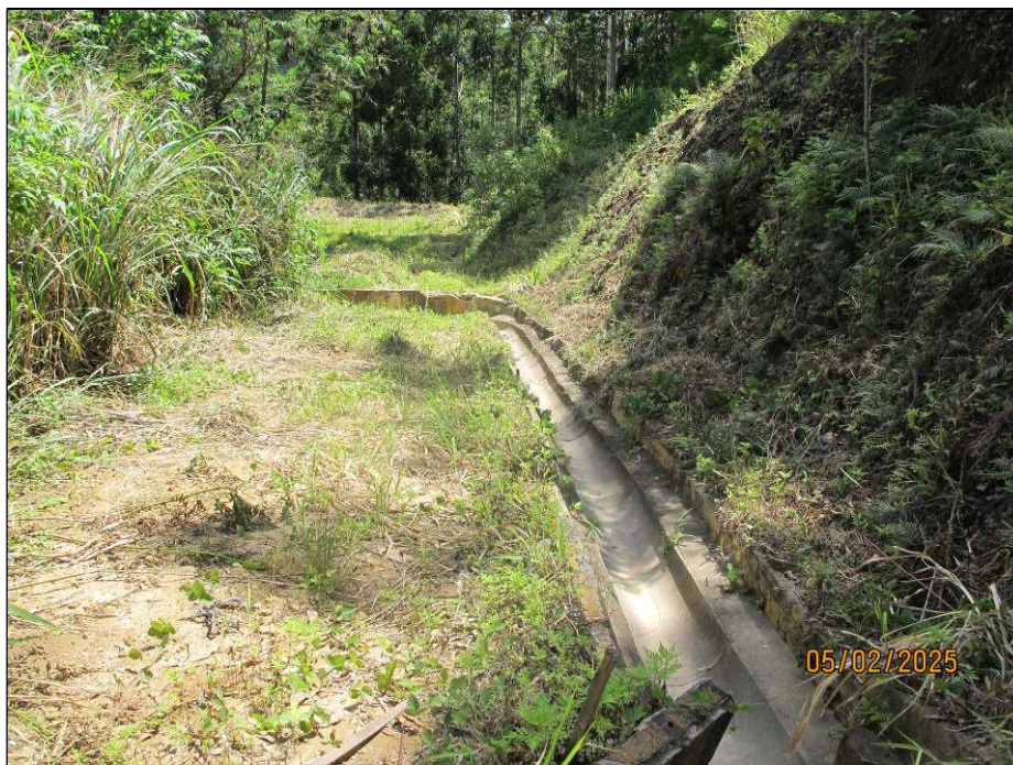
Figura 5.1- Vista da estrada de acesso à crista do barramento e do sistema de drenagem superficial principal.
