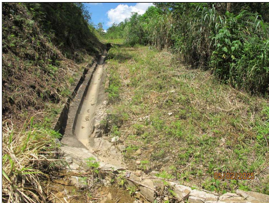
Figura 5.2- Vista do ponto de transferência do sistema de drenagem superficial para o emboque da escada de transferência de fluxo para o interior do reservatório.
