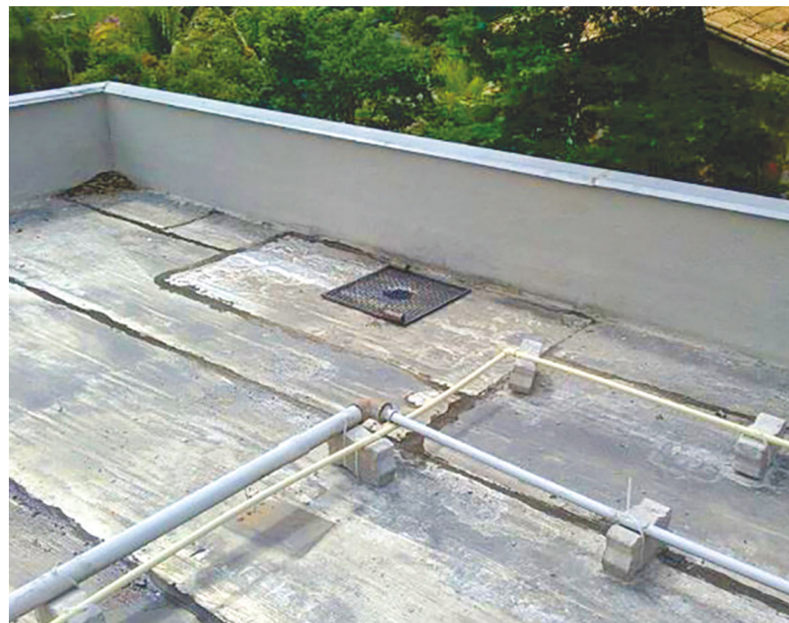
Laje sem proteção
